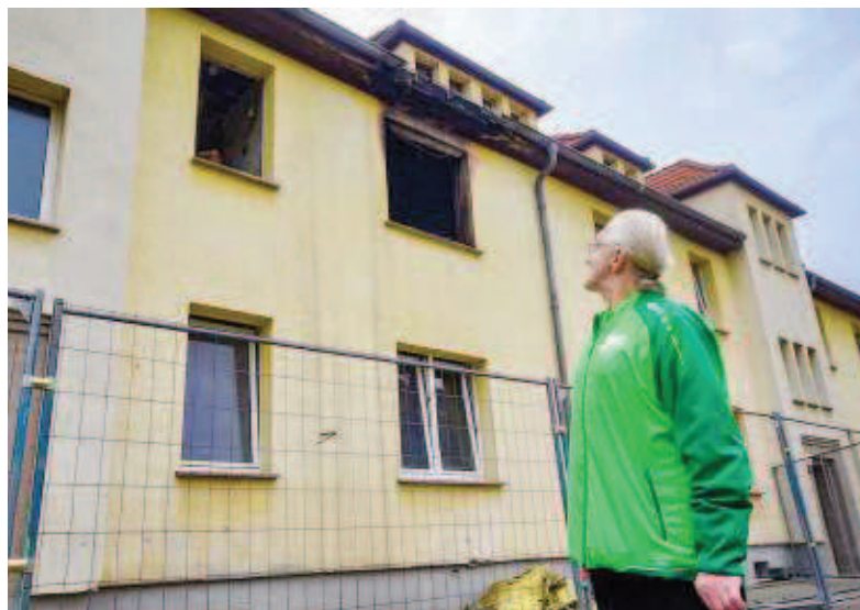
Peter Bößler steht vor seiner bisherigen Wohnung in dem Mehrfamilienhaus in Frankleben, in dem es gebrannt hat und das nun unbewohnbar ist.
